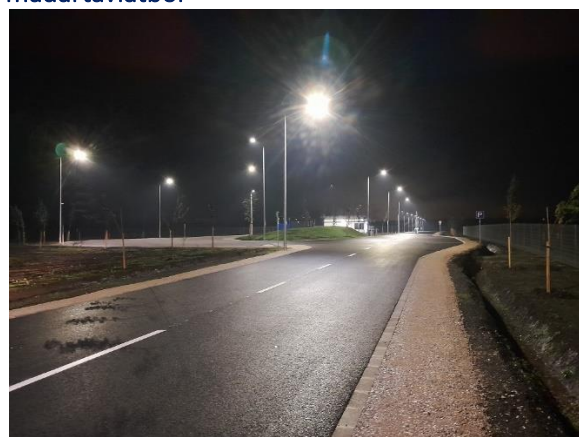
Korszerű térvilágítás a belső út mentén és a parkolóknban
