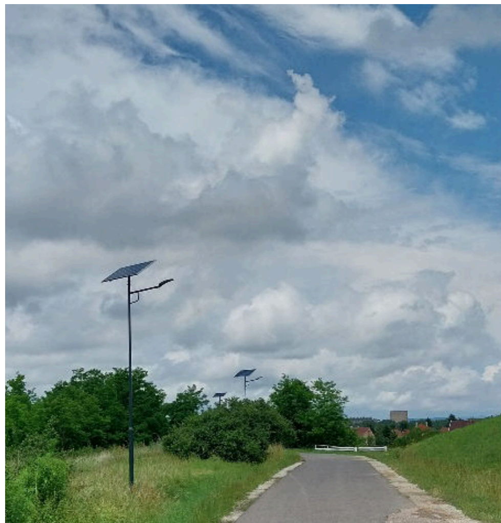
ÚJ NAPELEMES KÖZVILÁGÍTÁS AZ ERZSÉBET TELEPRE VEZETŐ ÚT MENTÉN
